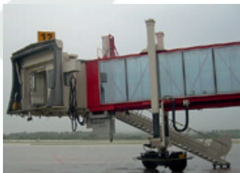
Подтрапный преобразователь 400Гц с кабельной катушкой
