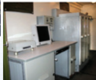
Автоматизированная система контроля ЗИ-РК-01-1 (общий вид и вид внутри кузова-контейнера)
