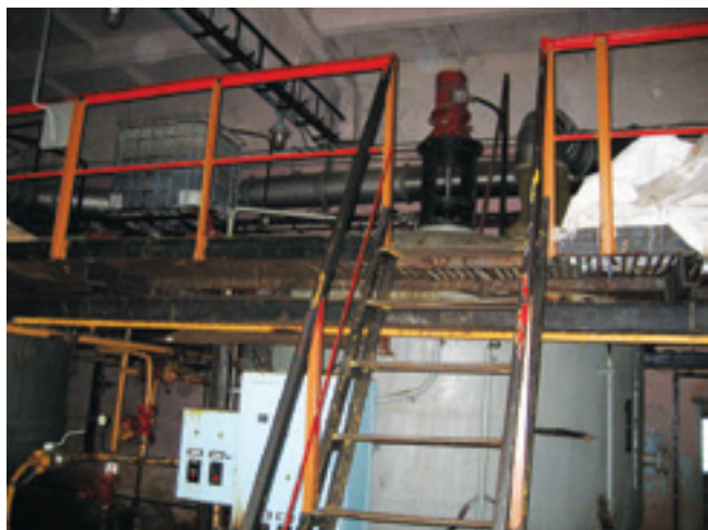
ЗАО «Рошальский химический завод «НОРДИКС»
